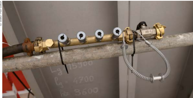
(Rampe pour alimentation en air comprimé)
